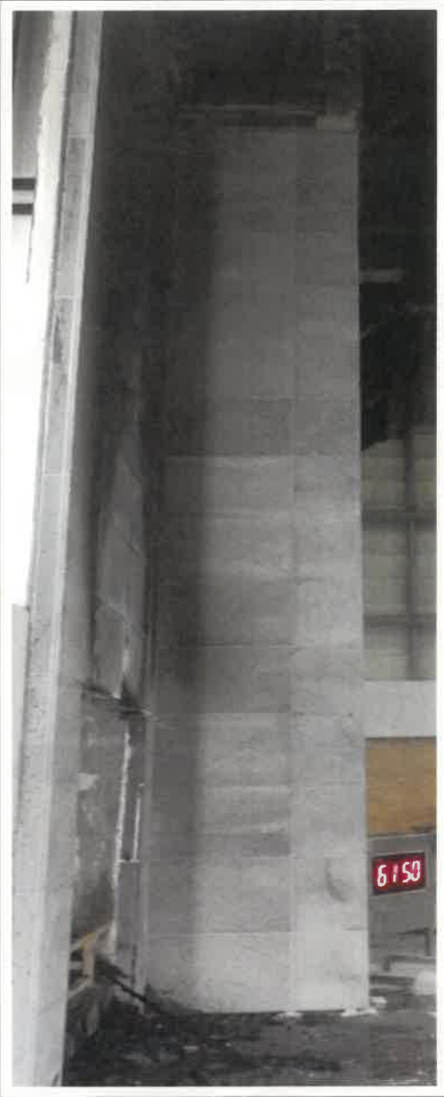
< 시험 후 시험체_측면 >
